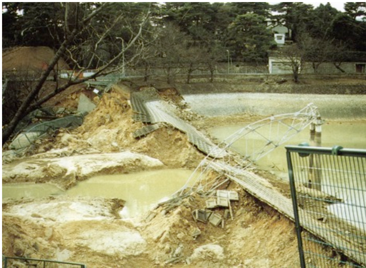
ニテコ池中堤の崩壊（西宮市水道局）
