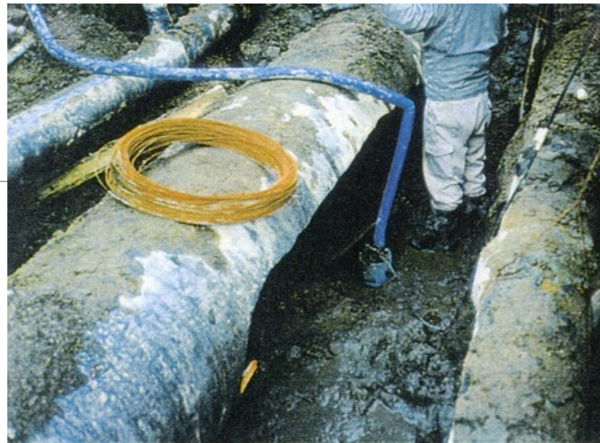
Φ800mm CIPの破損（神戸市水道局）
