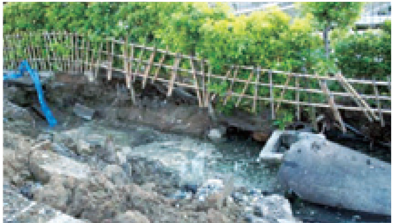
岡山市水道局の配水管破裂事故における破裂した配水管（口径1000mm）（出典；田町一丁目地内漏水事故報告書（平成19年7月20日岡山市水道局））
