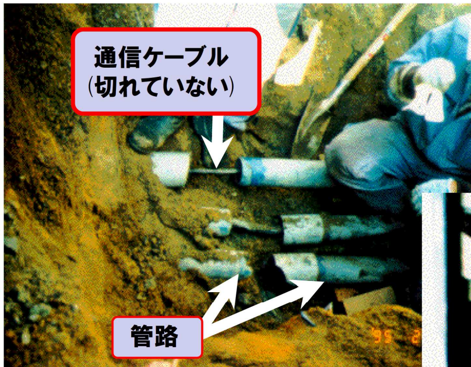
外れた地下管路
