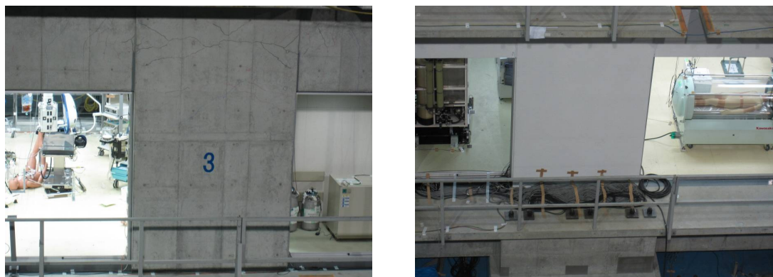
写真2 仕上げの違いによるクラックの発生状況の違い
