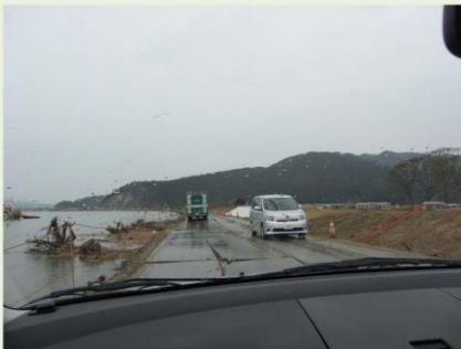
河口付近の月浜でも左岸堤防の決壊 L=3770m -0.8+20m-2.8K+192r
