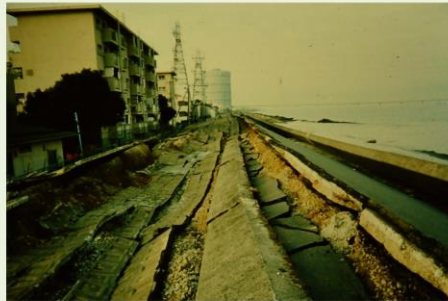
大阪 淀川左岸堤防 酉島 1995年阪神大震災時の被害 最大沈下量=3.0m
