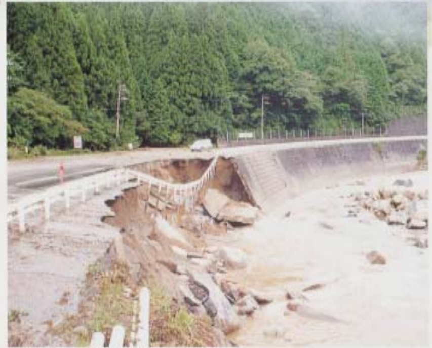
被災状況 (道路崩壊)
