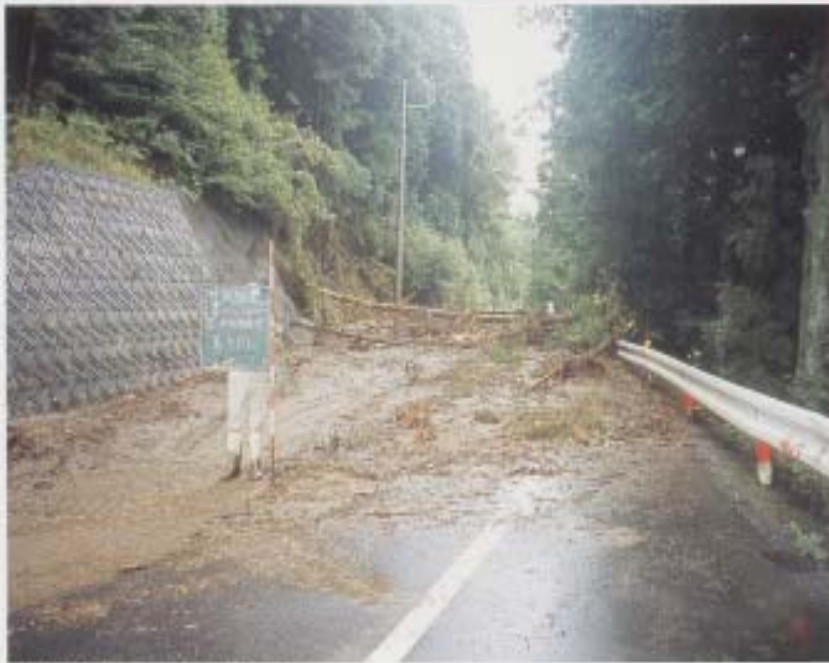
被災状況 (土砂流出)
